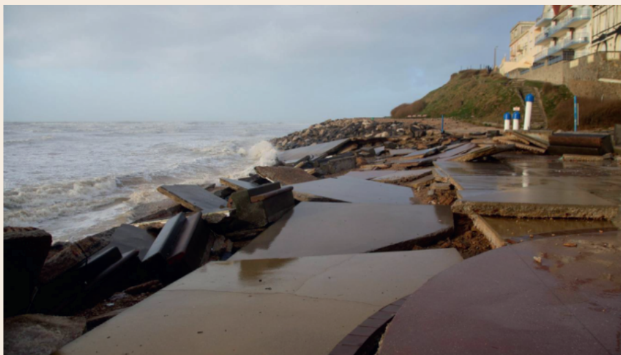
Figure 11. La digue de Wimereux détruite par la tempête Eleanor en janvier 2018 (source : La Voix du Nord ).
